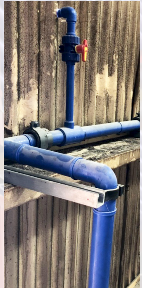
Air-Pro® cubierto de polvo químico en una planta de fabricación de fertilizantes.
