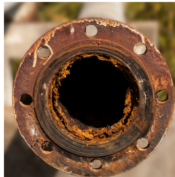
Ejemplo de d.i. de un tubo corroído
